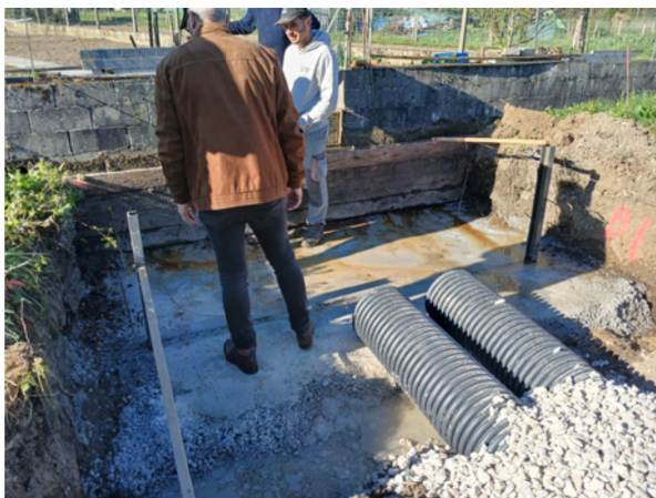
Vanne de décharge
